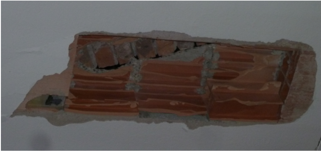
Base di un muro posto nel sottotetto vista dal primo piano osservando l'intradosso del solaio sfondellato, si nota che il solaio è privo di soletta collaborante
