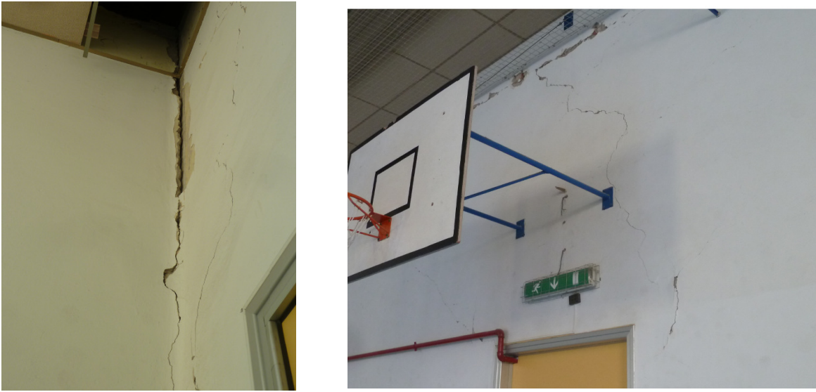
FIGURA 7 – Lesioni alle murature della palestra
